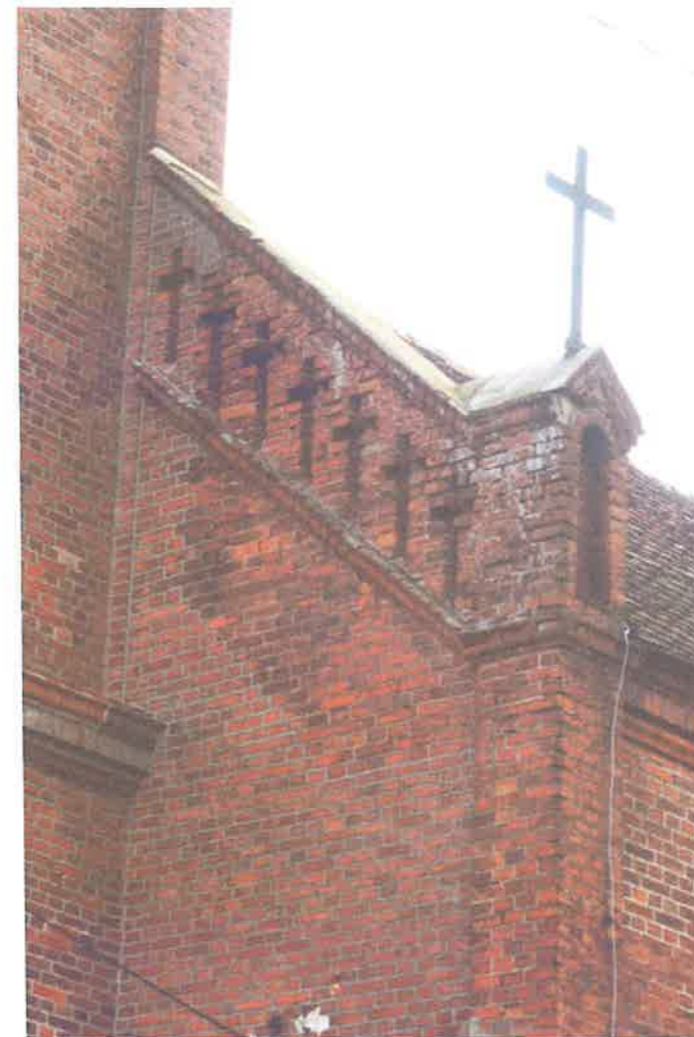
Fot. 10 Szczyt zachodni. Ubytki spoiny.
