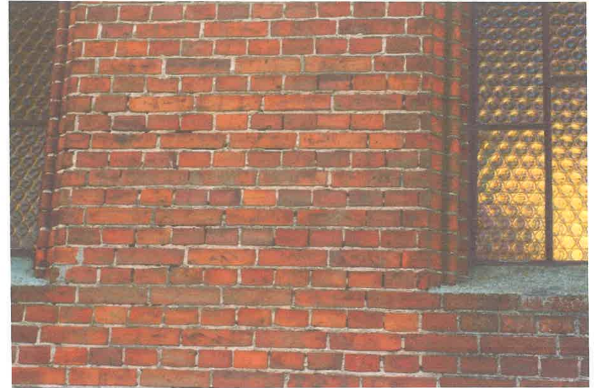
Fot. 19 Fragment elewacji północnej. Wypłukane spoiny.
