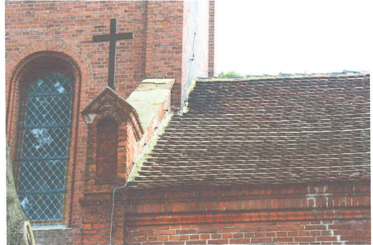
Fot. 11 Elewacja południowa. Ubytki w szlachie pokrywającej koronę muru.
