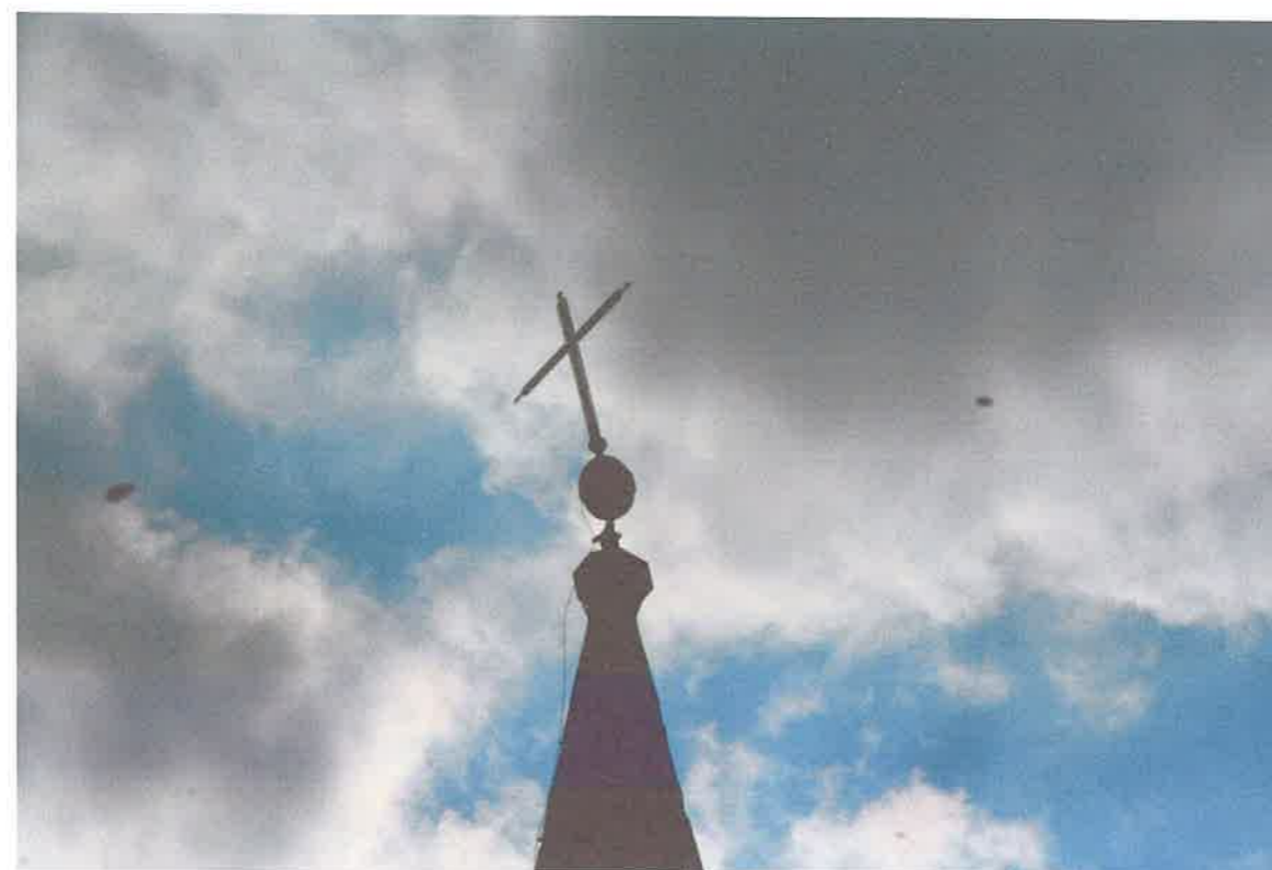
Fot. 13 Uszkodzony krzyż wieńczący wieżę.
