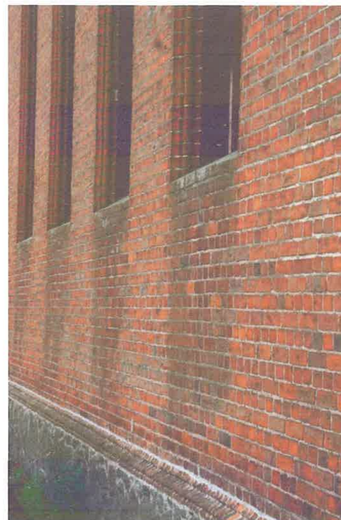
Fot. 8 Elewacja północna. Fragmenty ścian porośnięte glonami i porostami.
