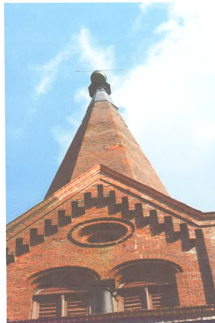
Fot. 14 Ubytki cegły licującej pokrycie hełmu wieży. Uzupełnienia gzymsu z nowej kształtki.
