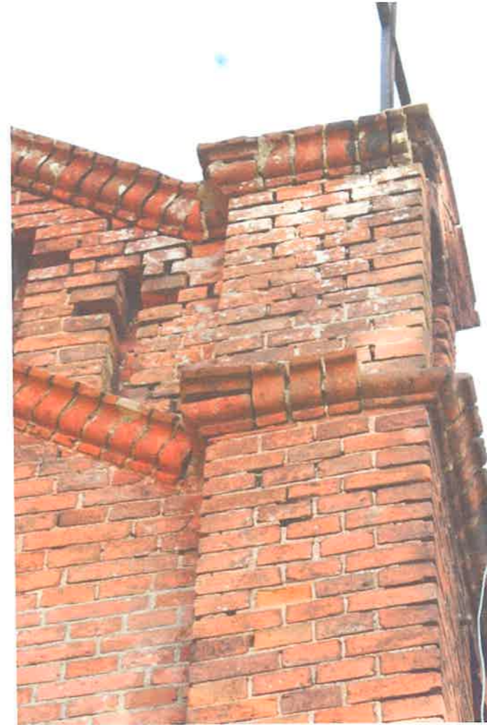
Fot. 20 Południowo-zachodni narożnik budynku. Luźne kształtki grożące upadkiem.
