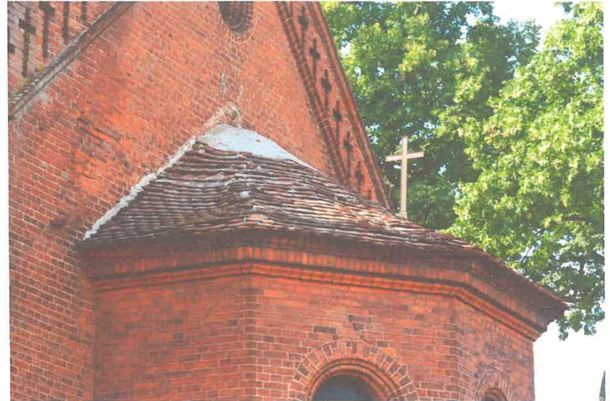
Fot. 15 Dach nad absydą. Zapadnięte połacie.
