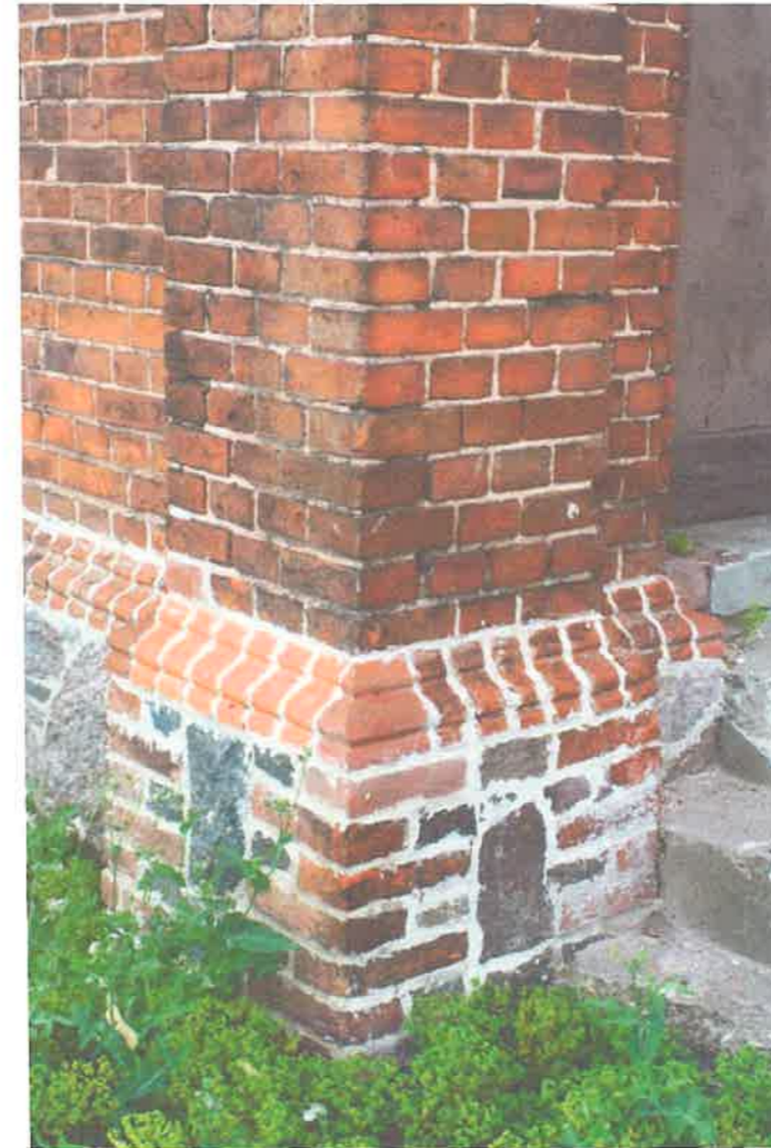
Fot. 12 Niestarannie wykonane spoinowanie cokołu, wyraźnie odcinające się kolorem nowe kształtki.
