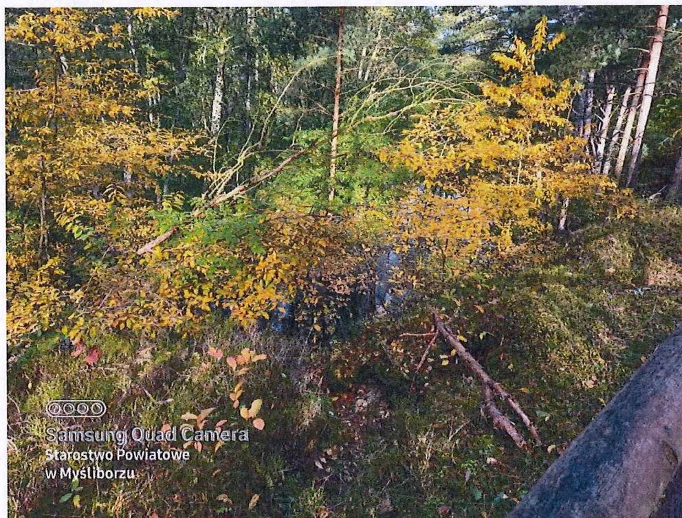
Fot. 5 Widok na skarpe osuwiska za ogrodzeniem – w dole rzeka Myśla.
