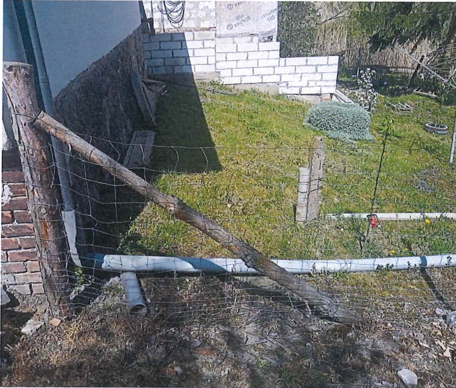
Fot. 7 Widok ogólny na północną stronę terenu zagrożonego ruchami masowymi ziemi za zamieszkałą posesją – brak zmian w morfologii zbocza; na budowlach nie stwierdzono uszkodzeń powodowanych ruchami masowymi ziemi.
