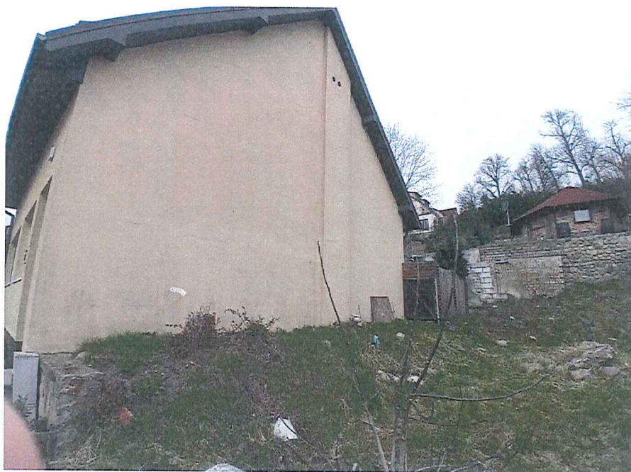
Fot. 24 Widok na boczną ścianę budynku na posesji przy ul. Górnej 19 (dz. nr 131/5 i 131/2 obr. 1-Barlinek) – nie stwierdzono przesunięć ziemi, spękań gruntu, uszkodzeń lub zniszczenia obiektu w wyniku ruchów masowych ziemi.
