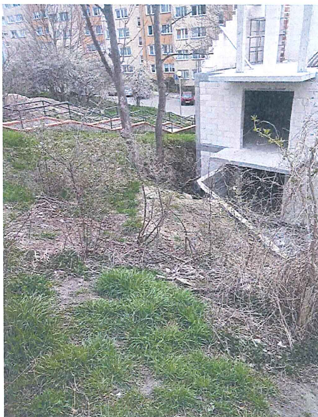
Fot. 7 Widok na ścianę tylną nowobudowanego budynku na dz. nr 154 obr. Barlinek-1 oraz murek oporowy, położonych na terenie zagrożonym ruchami masowymi ziemi – nie stwierdzono przesunięć/spękań/uszkodzeń, nie stwierdzono ruchu gruntu; w oddali schody prowadzące z przedszkola publicznego (ul. Podwale 11) na ulicę Górną.
