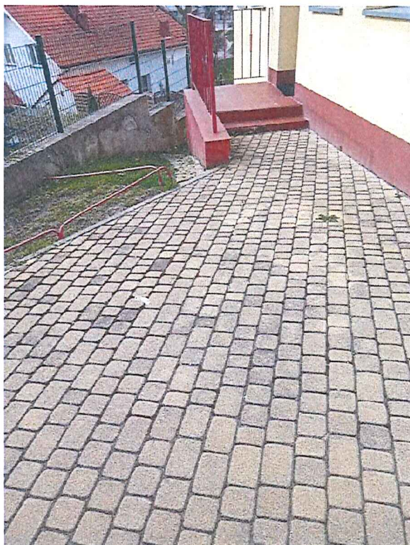
Fot. 6 Widok na ścianę tylną budynku przedszkola publicznego (ul. Podwale 13) oraz chodnik z kostki i murek oporowy, położonych na terenie zagrożonym ruchami masowymi ziemi – nie stwierdzono przesunięć/spękań/uszkodzeń.
