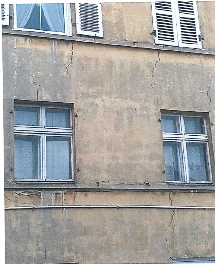
Fot. 19 Widok na frontową ścianę budynku posesji ul. Górna 11 (dz. nr 114/13 obr. 1-Barlinek) – stwierdzono na niej spękania pod i nad otworami okiennymi.
