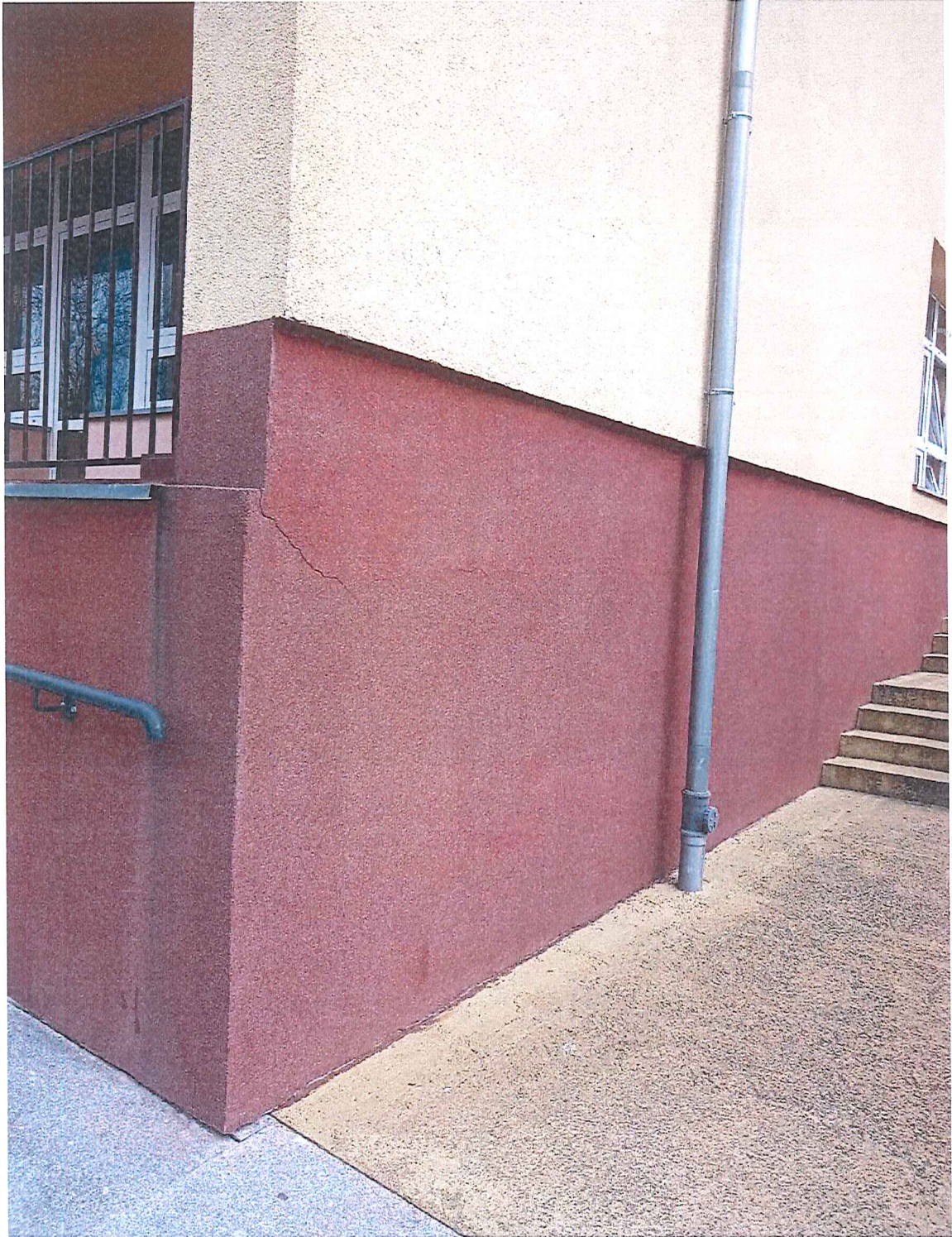
Fot. 5 Widok na ścianę tylną budynku (przed schodami) przedszkola publicznego (ul. Podwale 11), położoną na terenie zagrożonym ruchami masowymi ziemi - widoczne spękanie ściany.
