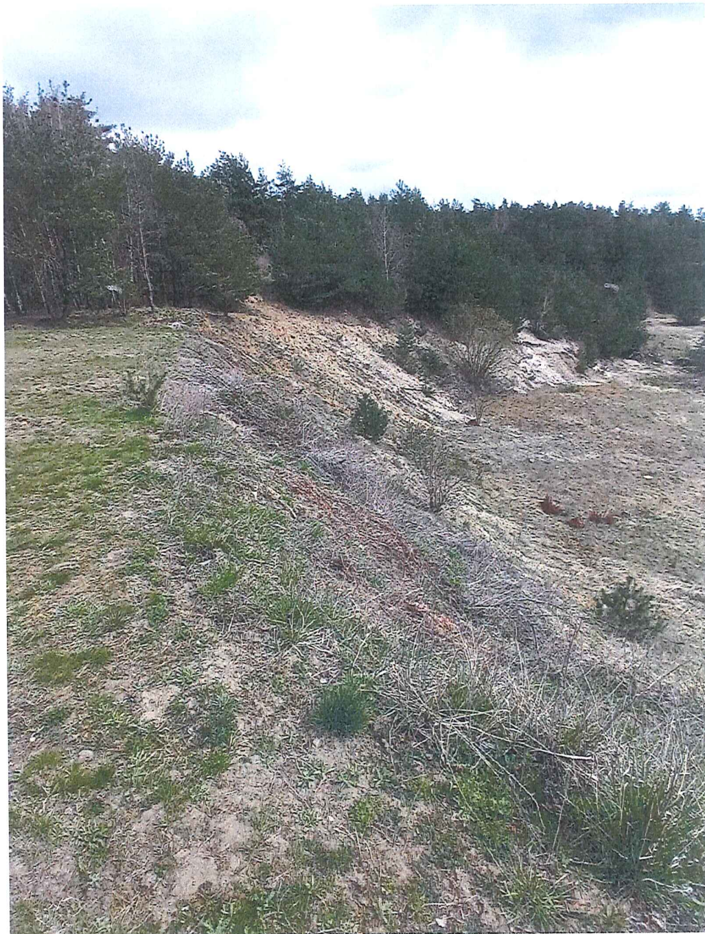
Fot. 12 Widok ogólny ze skarpy na część północną terenu zagrożonego ruchami masowymi ziemi; widoczna niezadarniona skarpa od strony lasu, obsypujący się materiał piaszczysto-gliniasty; skarpy niezabezpieczone, nieustabilizowane.
