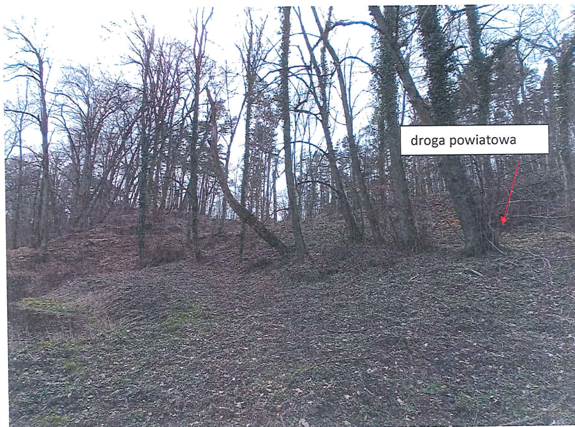
Fot. 12 Widok na zbocze TZOMZ poniżej drogi; drzewa nieco przechylone; nie stwierdzono osunięć ziemi, obrywów, spękań gruntu; roślinności wodolubnej na zboczu.
