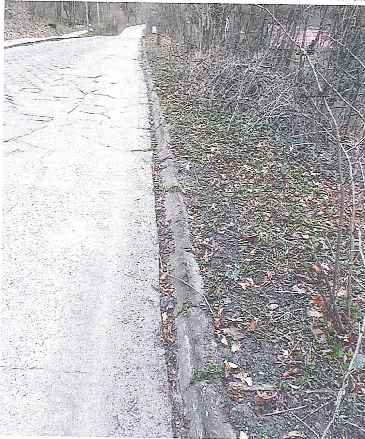
Fot. 14 Widok na drogę powiatową w stronę zakładu HACON (ul. Fabryczna); po prawej zboczce do cieku naturalnego; stwierdzono spękania nawierzchni drogi, przechylenie krawężnika, sugerujące osiadanie w kierunku cieku naturalnego.
