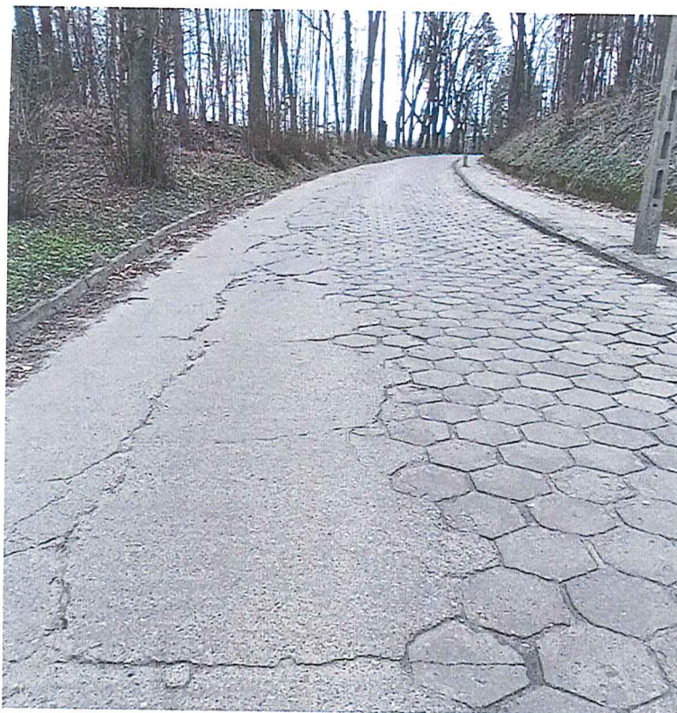
Fot. 13 Widok na drogę powiatową w stronę m. Barlinek (ul. Fabryczna); po lewej zboczce do cieku naturalnego; stwierdzono spękania nawierzchni drogi, sugerujące osiadanie w kierunku cieku naturalnego.
